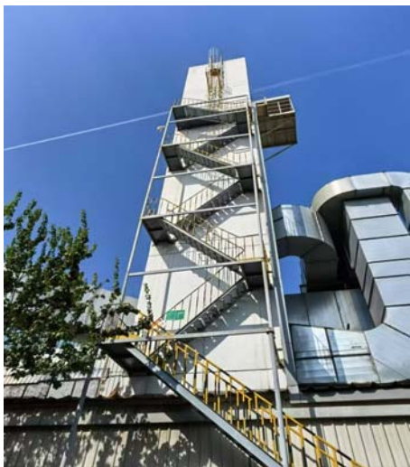
驱动桥涂装废气排气筒
