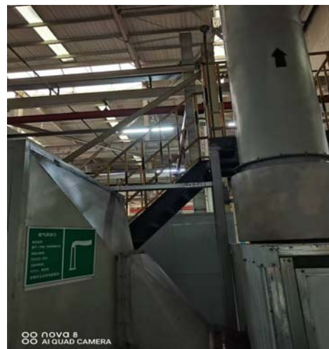
刷漆废气排气筒
