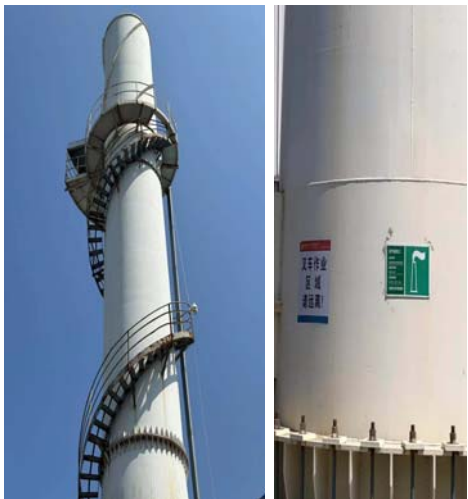
前桥涂装废气排气筒
